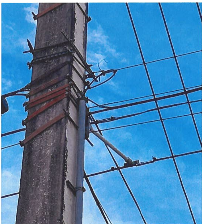
Poste con el conducto
