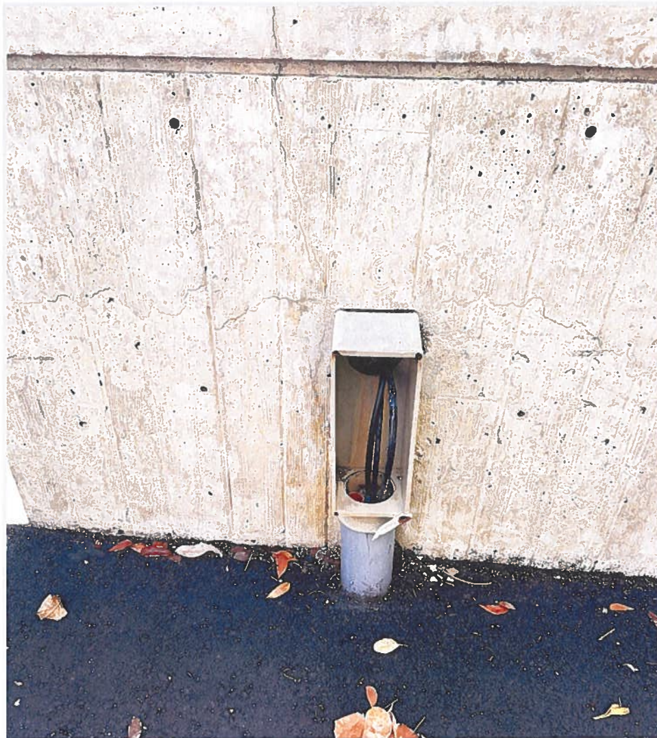
Caja de empalme desde la calle
