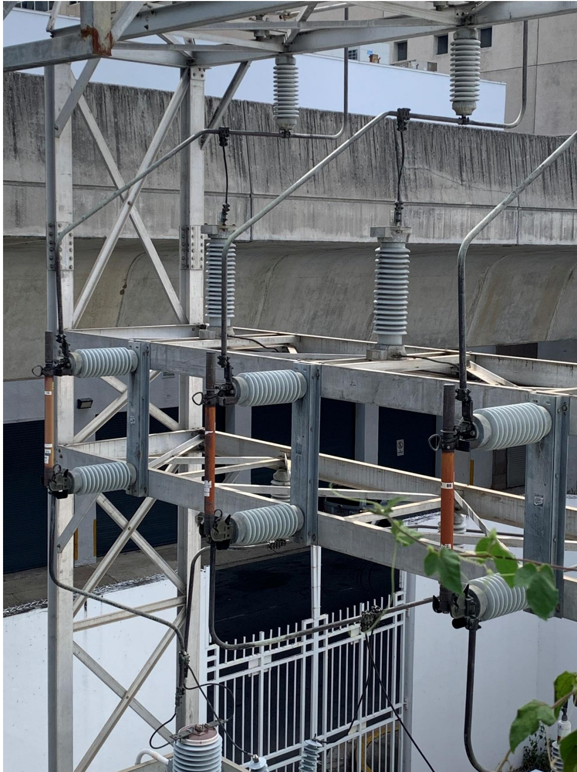
Foto de Subestación 6
